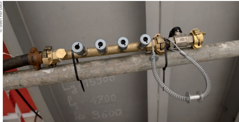
(Rampe pour alimentation en air comprimé)
