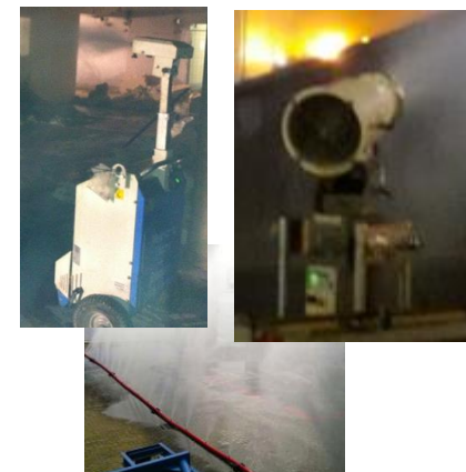
Dispositif de brumisation pour abattage des poussières
