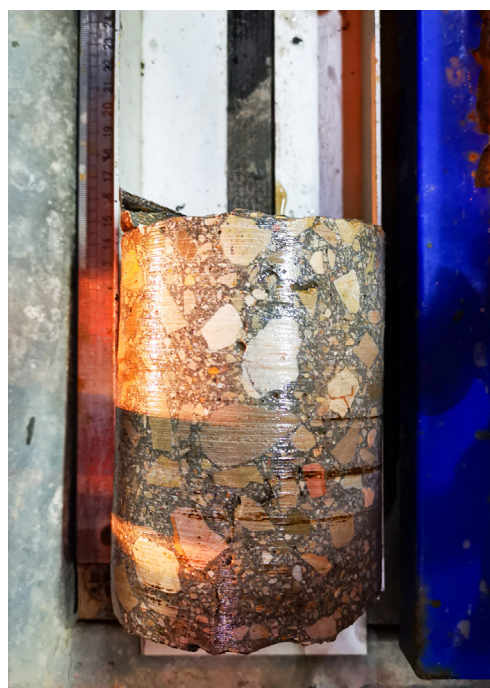
Figure 2 : coupe d'une carotte multicouche prélevée sur l'extrados d'un ouvrage d'art.
