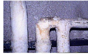
Calorifugeages de tuyaux
