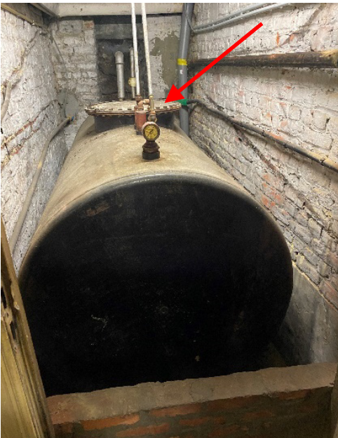
Het deksel van de stookketel is voorzien van asbest pakkingen met oog op brandveiligheid.
