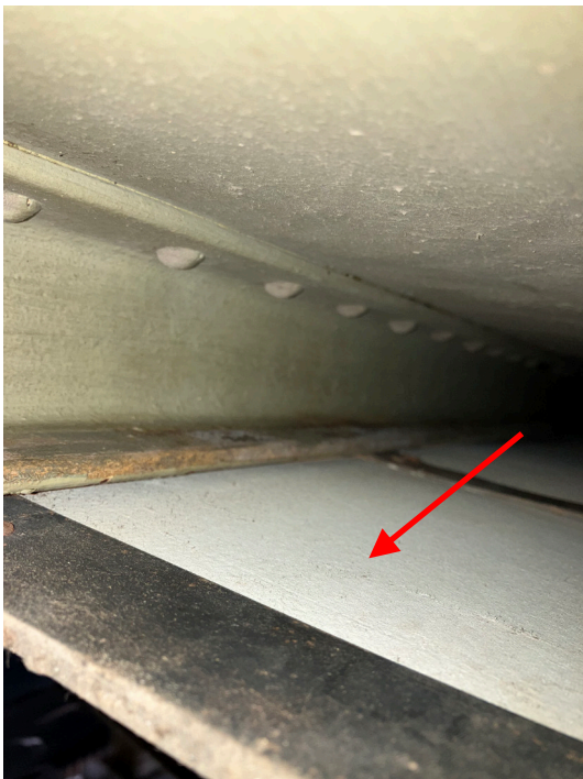
Asbestkarton in het brandscherm, zichtbaar vanuit een aantal openingen bovenaan.
