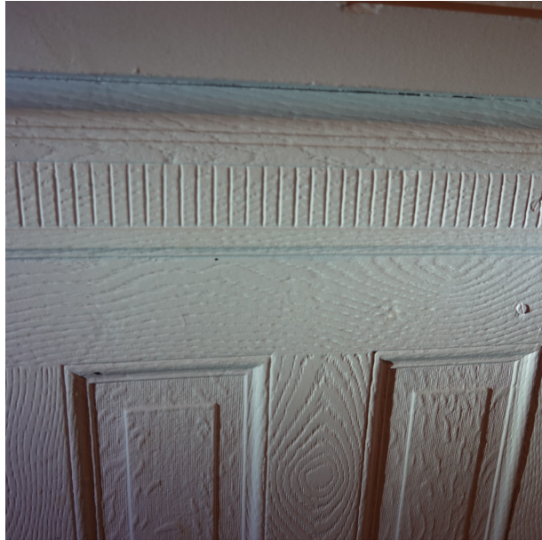
Asbestverdacht sierpaneel met houtimitatie in een kasteel
