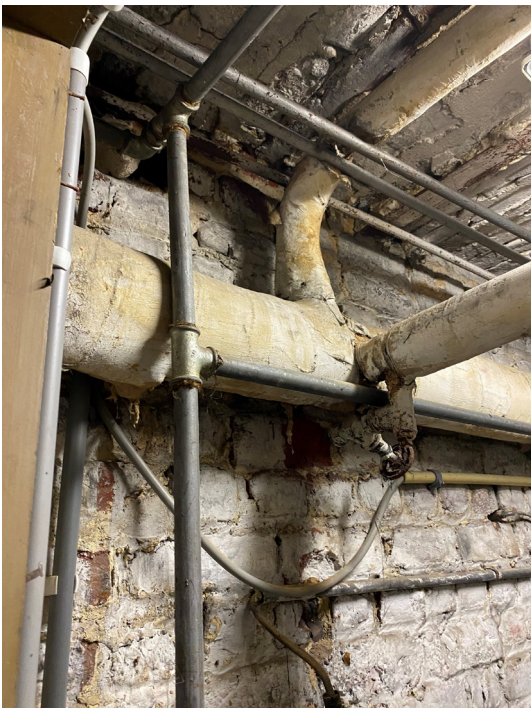
Asbestverdachte isolatie rond het buiswerk in een vroeg-20ste-eeuwse burgerwoning.
