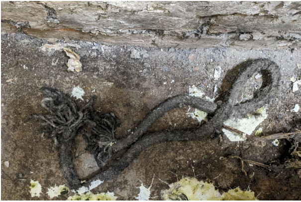
Asbestverdacht koord voor de afdichting van een schouwpijp.
