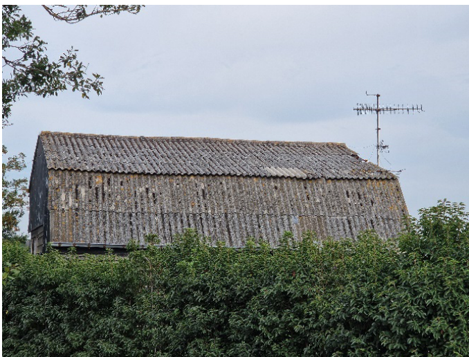
Golfplaten in asbestcement op een schuurtje in de Uitkerkse polder
