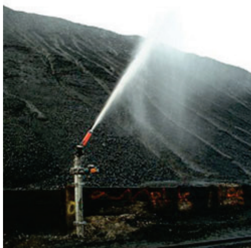
Figuur 31: Vaste sproeier ter hoogte van opslag (Phoenix Engineers, 2022)
