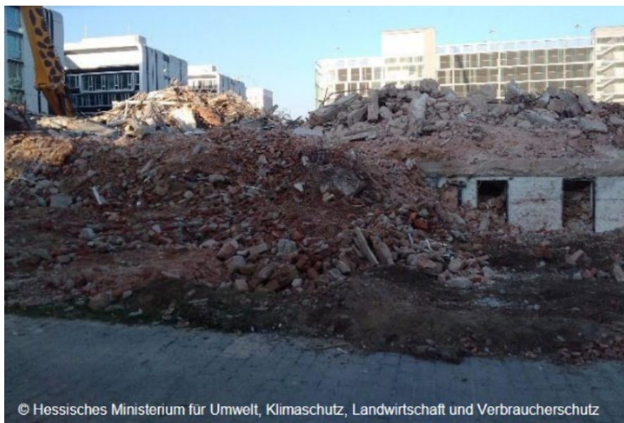
Figure 54 : Débris de démolition hétérogènes suspectés de contenir de l'amiante (source : LAGA, 2023)
