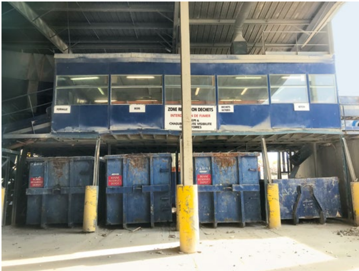
■ Figure 20. Bennes placées sous la cabine de tri permettant le conditionnement en vrac sans manipulation évitant la reprise ultérieure des déchets triés avec des chargeurs
