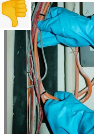
Dénudage par un électricien d'un ancien câble électrique dans lequel se trouve une tresse d'amiante
