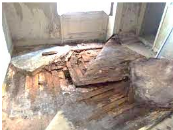
Risques d'effondrement du bâti (Ex: champignons, termites, etc.)
