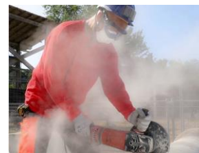
Risques d'exposition à la poussière de béton (silice)
